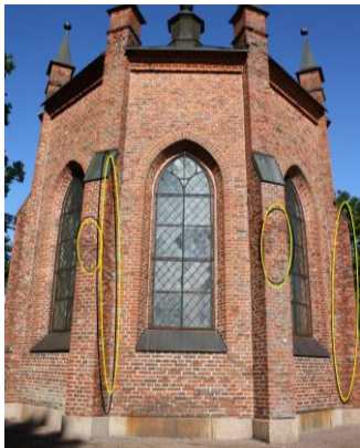
Kuva 13. Kontreforit ovat ulkonevia ja saumojen rapautuminen on kohdistunut niihin.
