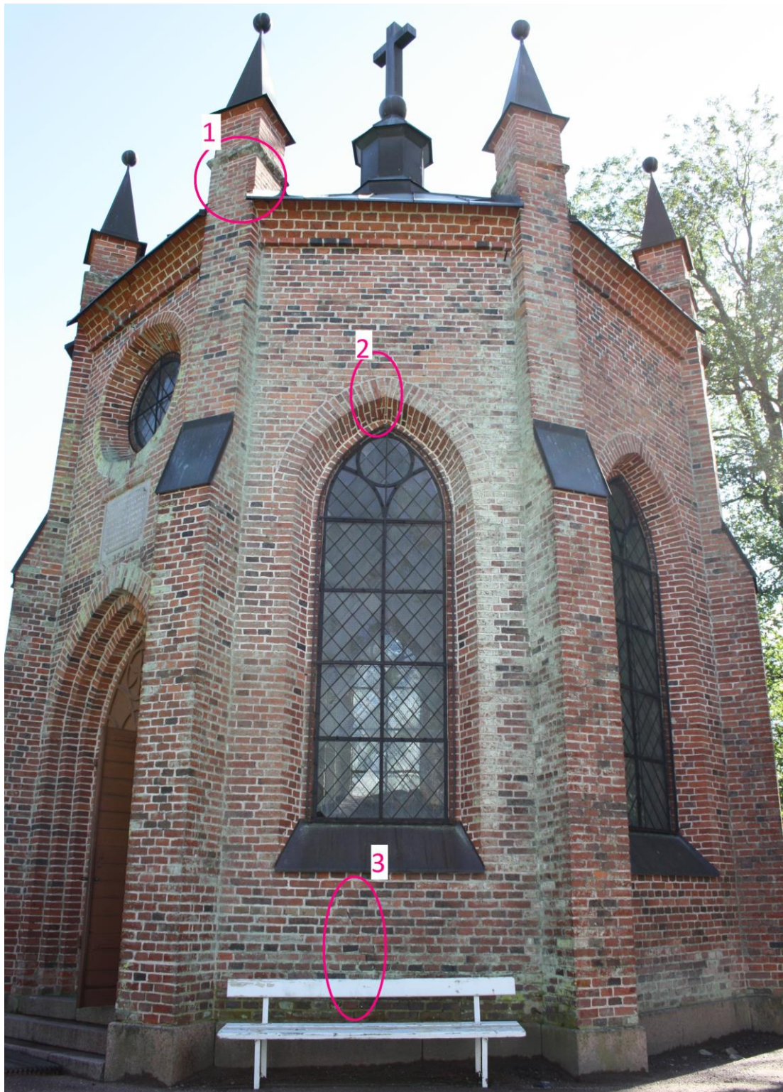
1= Pakkasrapautumaa tiilissä ja saumoissa. 2=Halkeama. 3=Halkeama. Huomattavat orgaaniset kasvustot.
