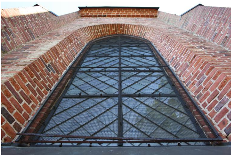
Kuva 18. Kuvassa näkyy ikkunoiden rakennetta ja suojaverkon vaurio.
