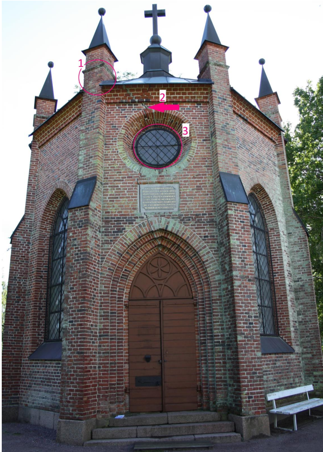
1= Pakkasrapautumaa saumoissa. 2=iso halkeama, joka jatku ovelle asti. Nuolen kohdalla mitattu max. leveys 2,2cm. 3=ikkuna on mahdollisesti liikkunut paikaltaan.
