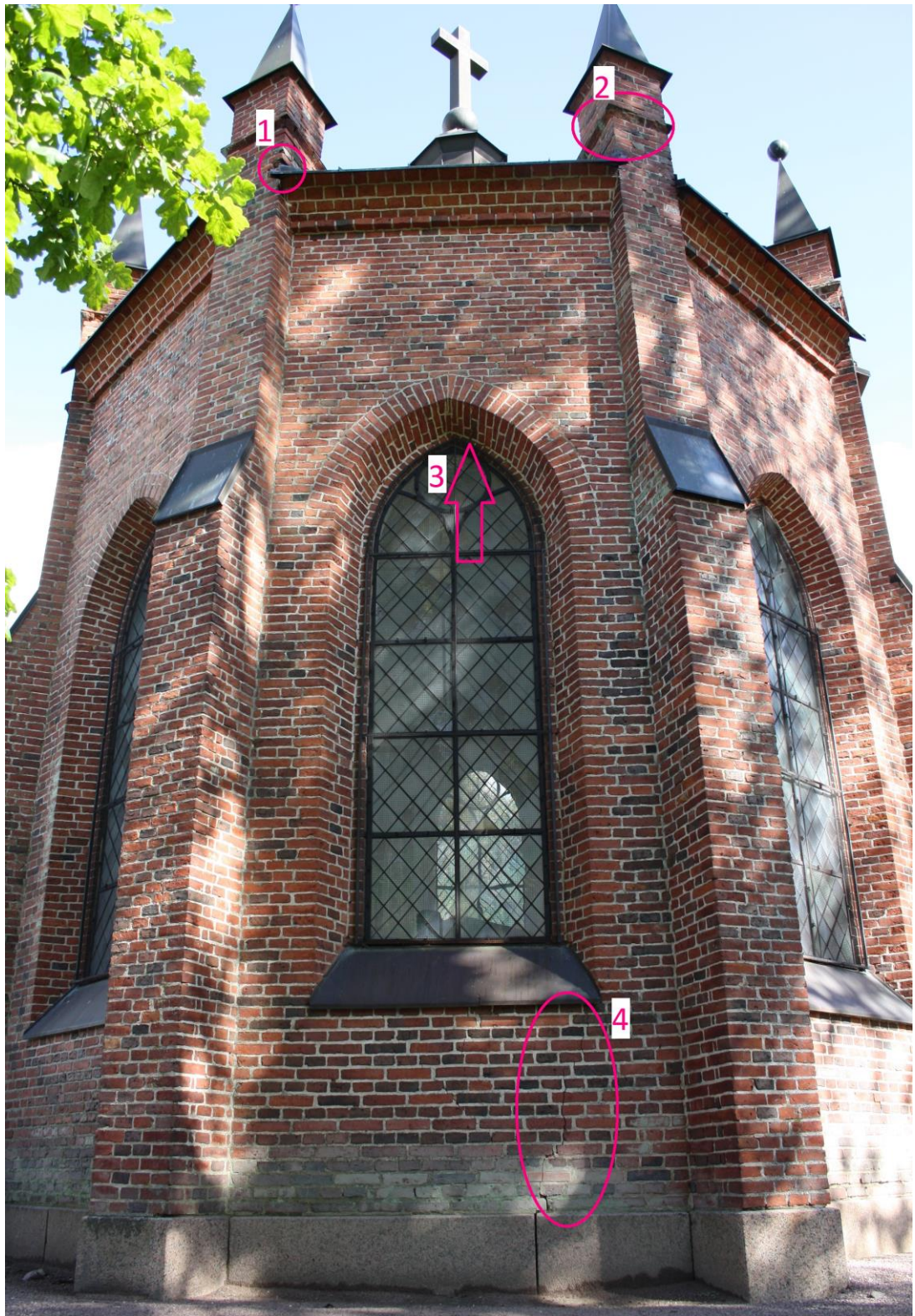
1=Pakkasrapautuma tiilessä. 2=Pakkasrapautumaa tiilissä ja saumoissa. 3=Pieni halkeama. 4= halkeama ja 70-luvun tiilisilta.
