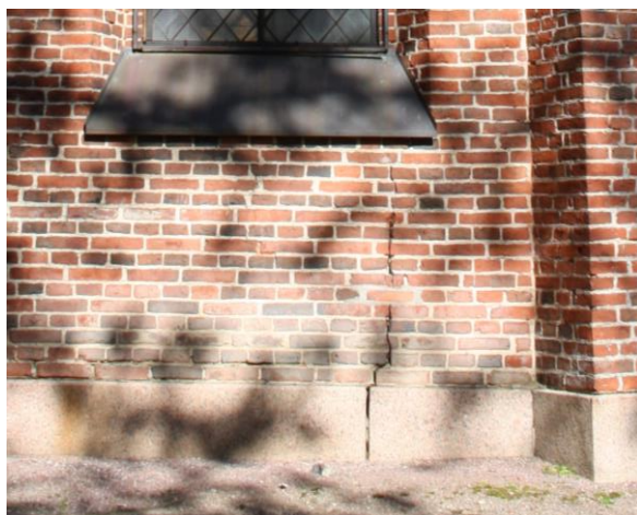
Kuva 7. Todennäköisesti perustusten liikkeistä aiheutunut halkeama tiilirungossa. Halkeama on epätyypillisesti melko pystysuora, eikä mukaile tiilien saumoja.
