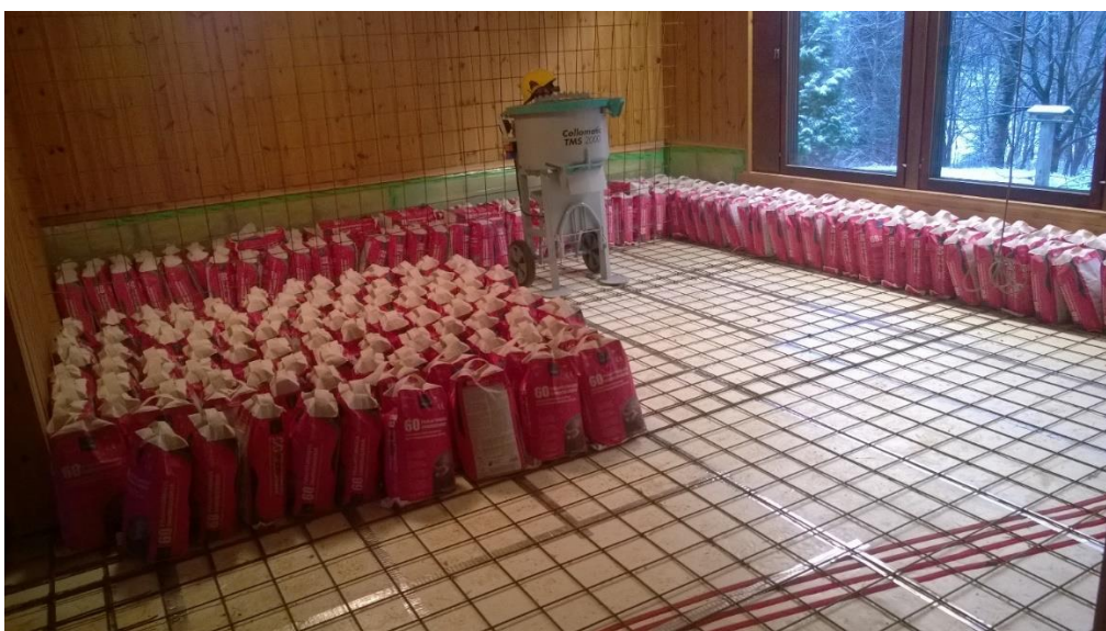
Kuva 8. Lattian valutyöt alakamassa. Valumassa otettiin huoneenlämpöön lämpiämään kolme päivää ennen valamista. Kuvassa näkyy myös Collomix TMS 2000 tasosekoitin. (Korhonen 2015)
