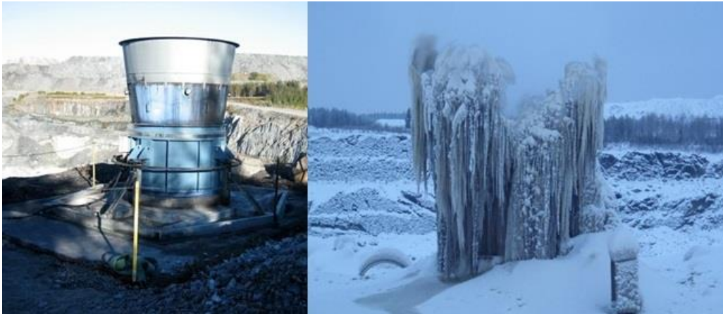
Kuva 8. IVN 4 kesällä ja talvella (Kaivoksen ilmanvaihto 2013)
