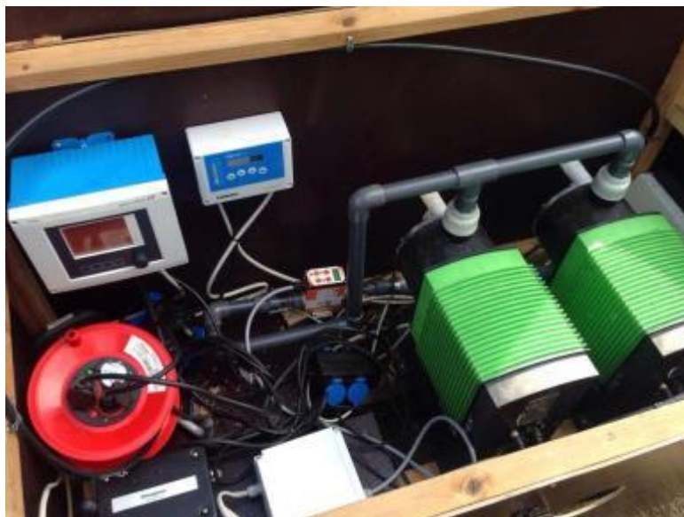
Kuva 5. Kuva pumppujärjestelmästä (Kuva: Sonja Risti)
