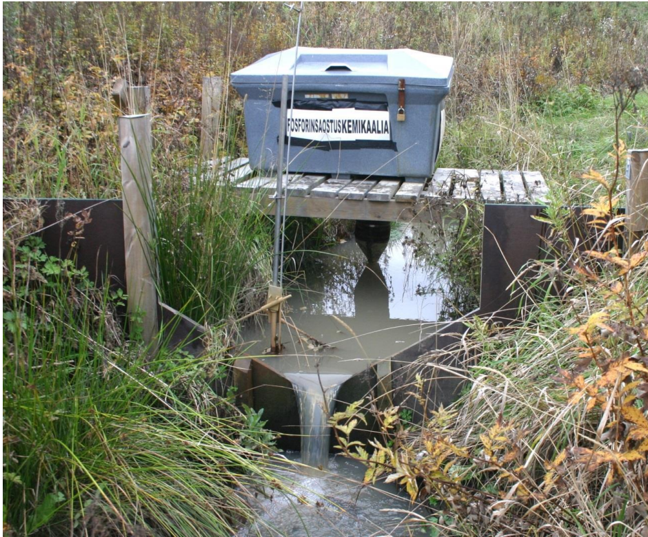
Kuva 10. Nautelassa käytetty ferrisulfaattiannostelija. Takana kemikaalisäiliö, jonka alla näkyy kemikaalin annostelupää. Etualalla on virtaaman mittauksessa hyödynnetty v-pato (Kaseva 2013).
