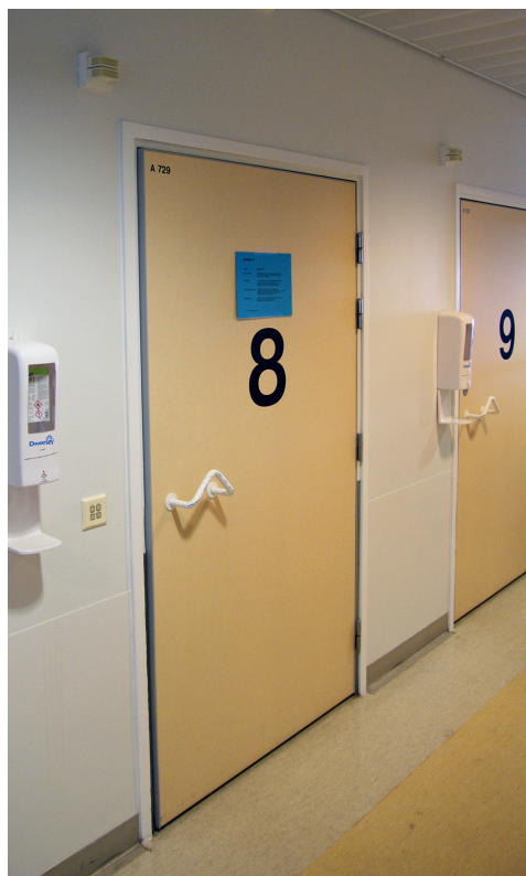
Kuva 3. Ilmaerityksestä kertova eristyskortti asennettuna potilashuoneen oveen.
