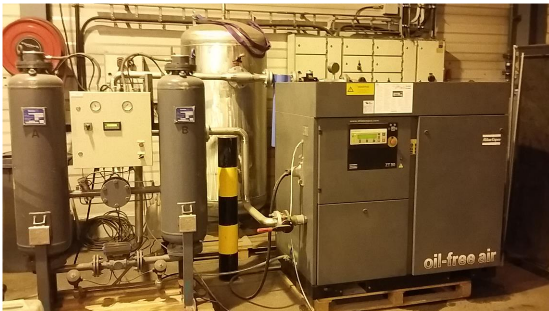
Kuva 8. Atlas Copco ZT30 ja kuivaimet tuotantovarastossa
