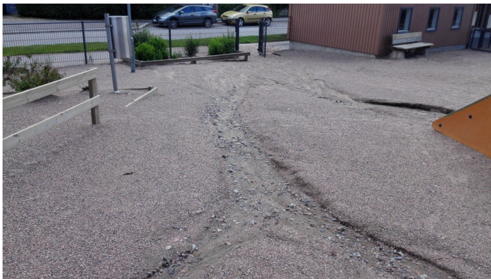
Kuva 10. Kivituhkapinta kulkeutuu hulevesien mukana alas kadulle ja tuhkauttaa myös istutukset sekä hankaloittaa kulkua pihalla (Eerikäinen 2016d).
