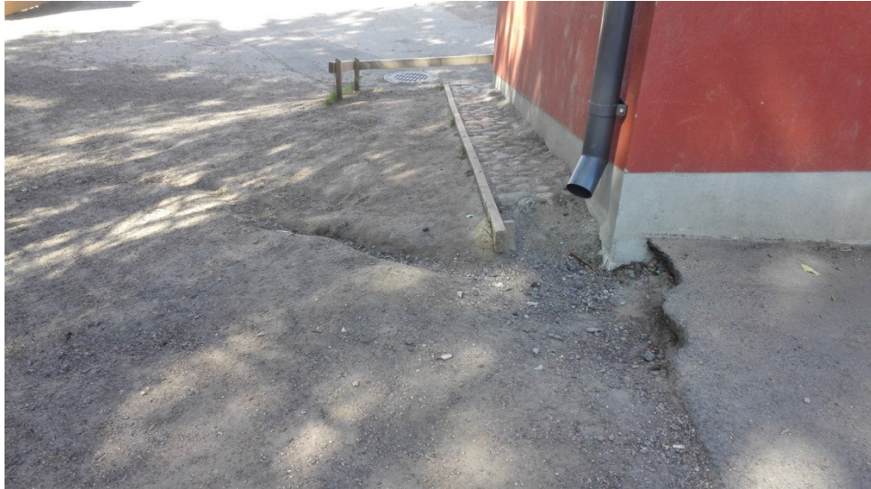
Kuva 11. Toteutusta ei ole mietitty loppuun asti: sadevedet ohjautuvat maahan, josta ne vievät hienoaineksen mennessään, syövyttävät viereisen asfaltin pohjat, seulanpääkiveyksen ja uurtavat sitomattomaan rinteeseen uran (Eerikäinen 2016e).
