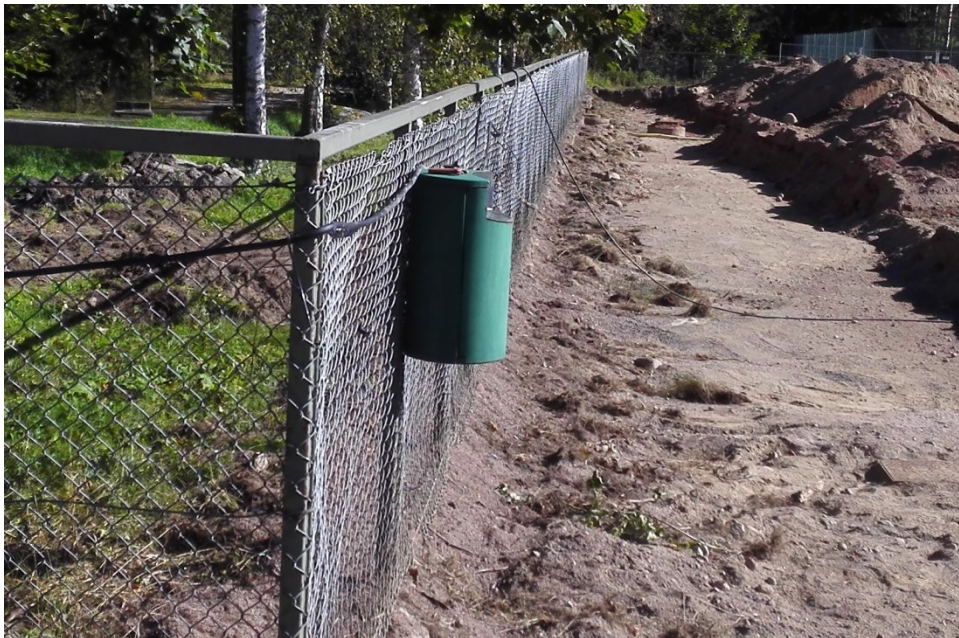
Kuva 9. Juoksuradan pohjia kaivettaessa esiin ilmestyi kaksi kaivonkantta, jotka jatkotutkimuksissa osoittautuivat käytöstä poistetuiksi (Eerikäinen 2016c).
