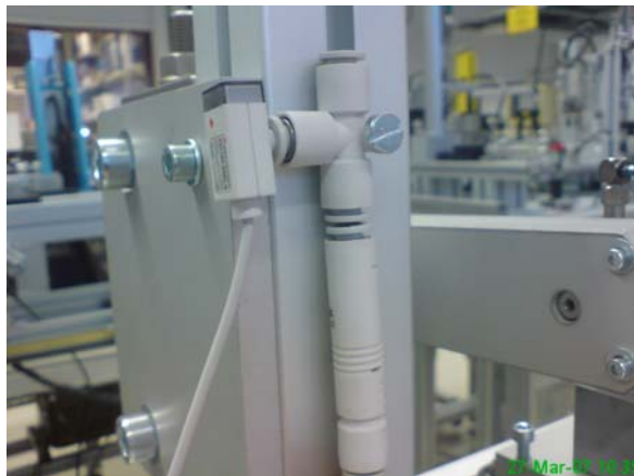
Kuva 20 Alipaine-ejektori ja anturi
