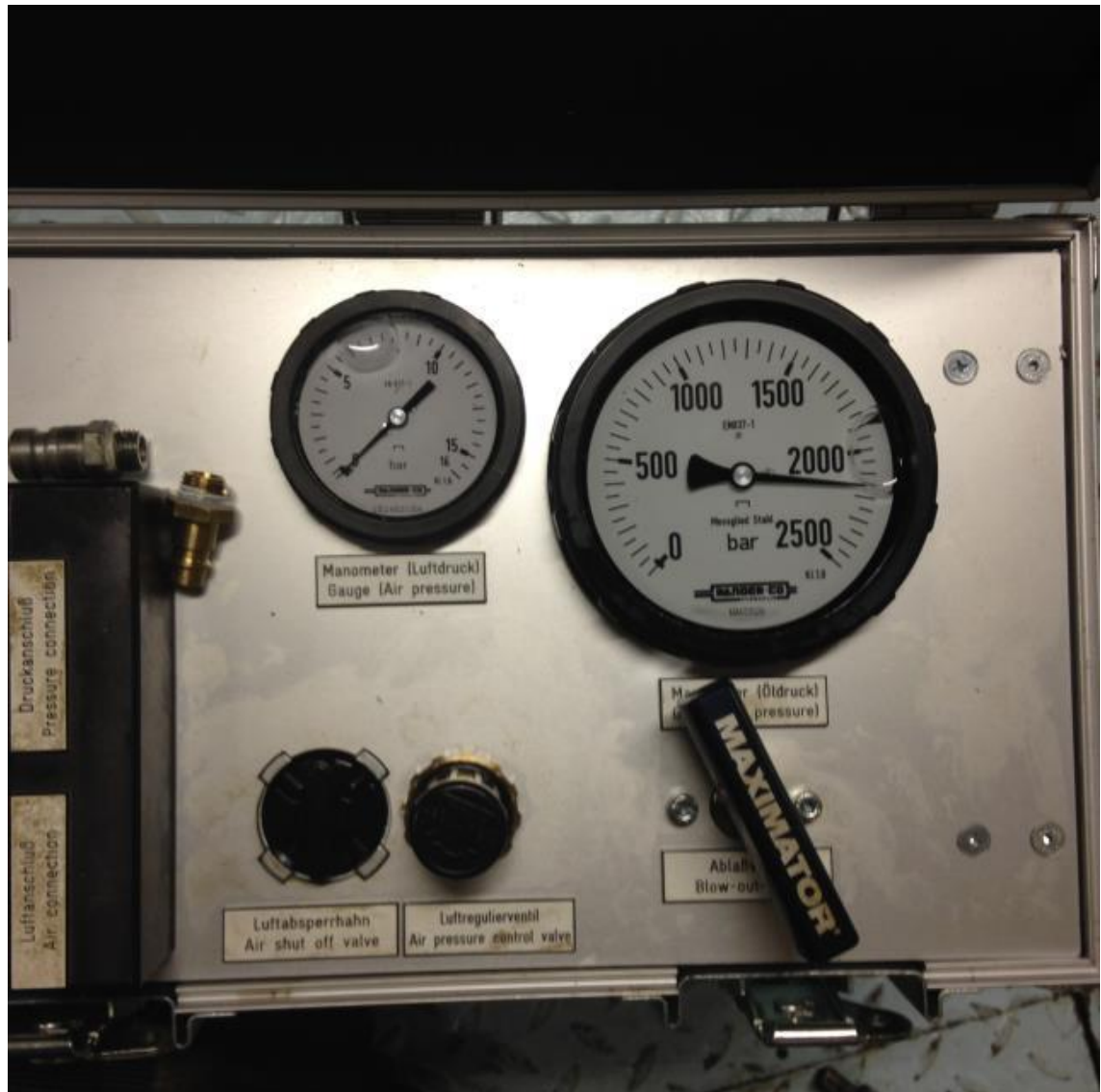
Kuva 18. Paineilmakäyttöinen korkeapaine hydraulipumppu ja avauspaineet.
