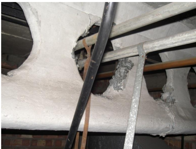
Kuva 1. Asbestospray teräspalkissa. (Fibre management 2017)
