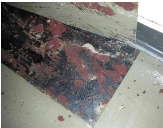
Kuva 27. Vinyylilaatta kiinnitetty asbestipitoisella bitumiliimalla. (Rakennustieto Oy 2016)
