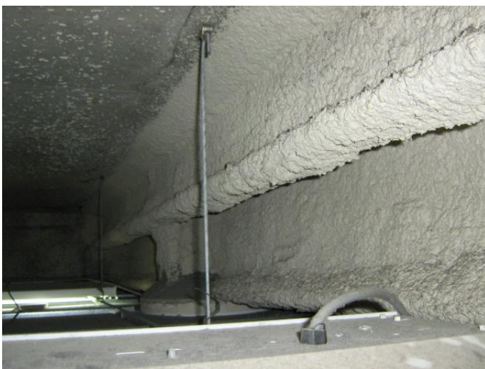
Kuva 2. Limpet-asbestiruiskutusmassapintaa. (Asbestos Check 2017)
