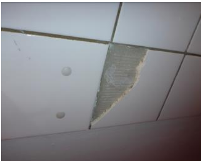
Kuva 22. Keraamisen laatan kiinnityslaasti saattaa sisältää asbestia. (Rakennustieto 2016)
