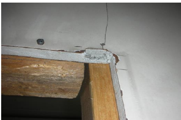
Kuva 3. Asbestipitoinen Navilite-väliseinälevy. (Rakennustieto 2016)
