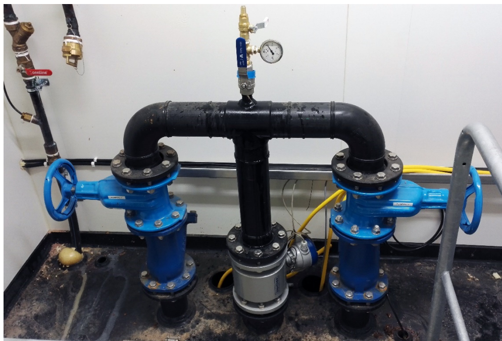
Kuva 14. Ekoparkin pumppaamon painemittausjärjestelyt
