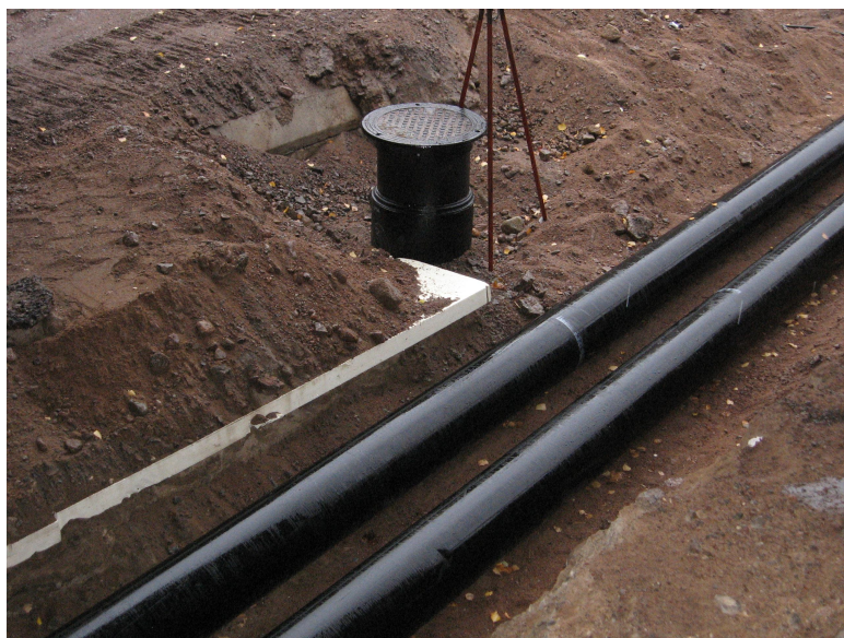
Kuva 5. Kaukolämpöjohto kadun alla.
