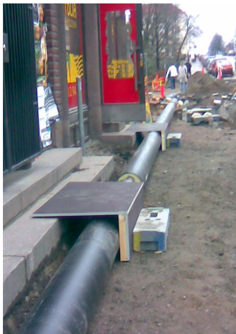
Kuva 11. Väliaikainen ratkaisu lämmön toimittamiseen (Kuva: Kimmo Mäkelä)
