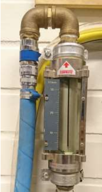
KUVA 6. LVI-laboratorion seinällä oleva virtausmittari
