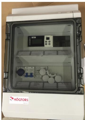
Kuva 22. MIX ohjauskeskus (1011OK01) [25].
