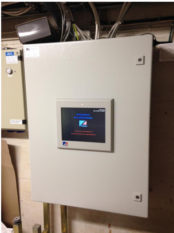
Kuva 30. Fidelixin valvonta-alakeskus (VAK-A). Kuva työmaalta.
