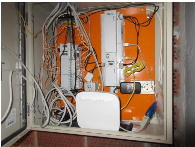
Kuva 20. Nykyinen valvonta-alakeskus (Siemens).
