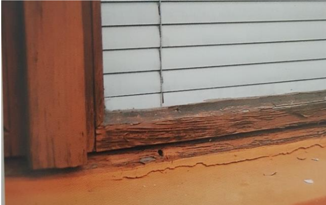
Kuva 11. Kosteuden aiheuttamat vauriot ikkunarakenteessa (Rakennusteollisuus 2004, 41)
