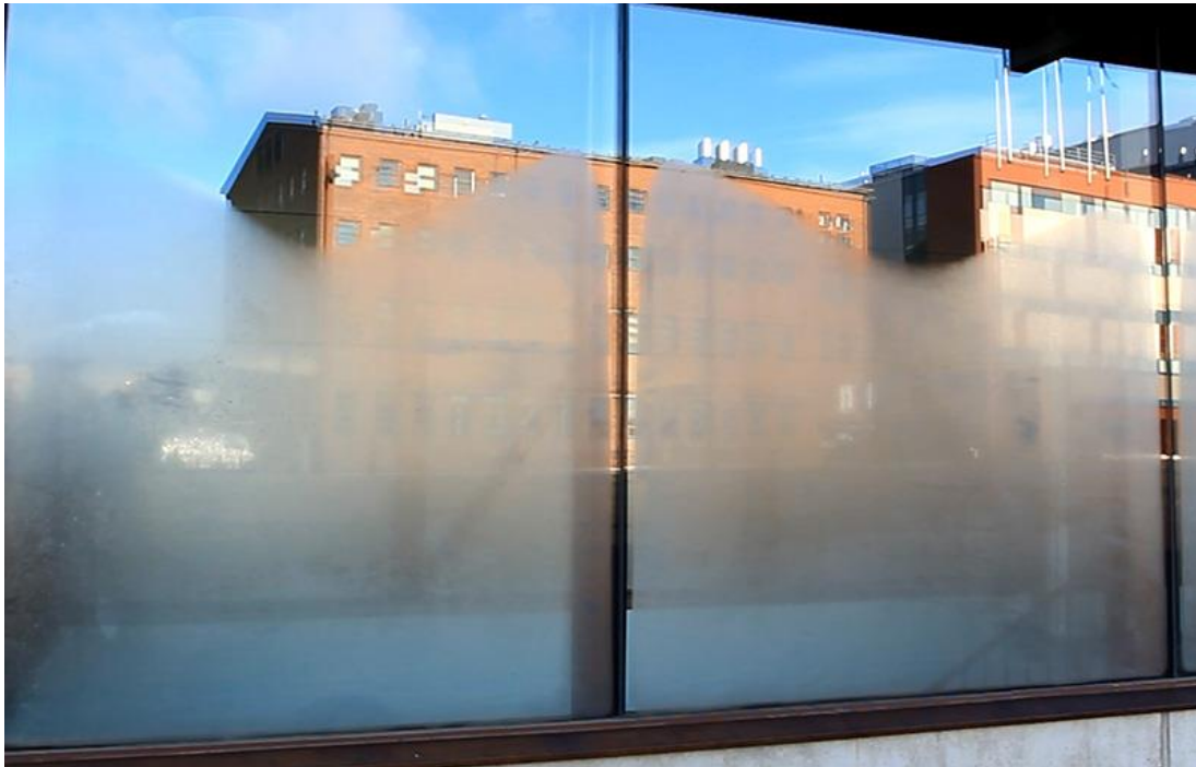
Kuva 5. Ikkunan huurustuminen ( Pihla, 2017)
