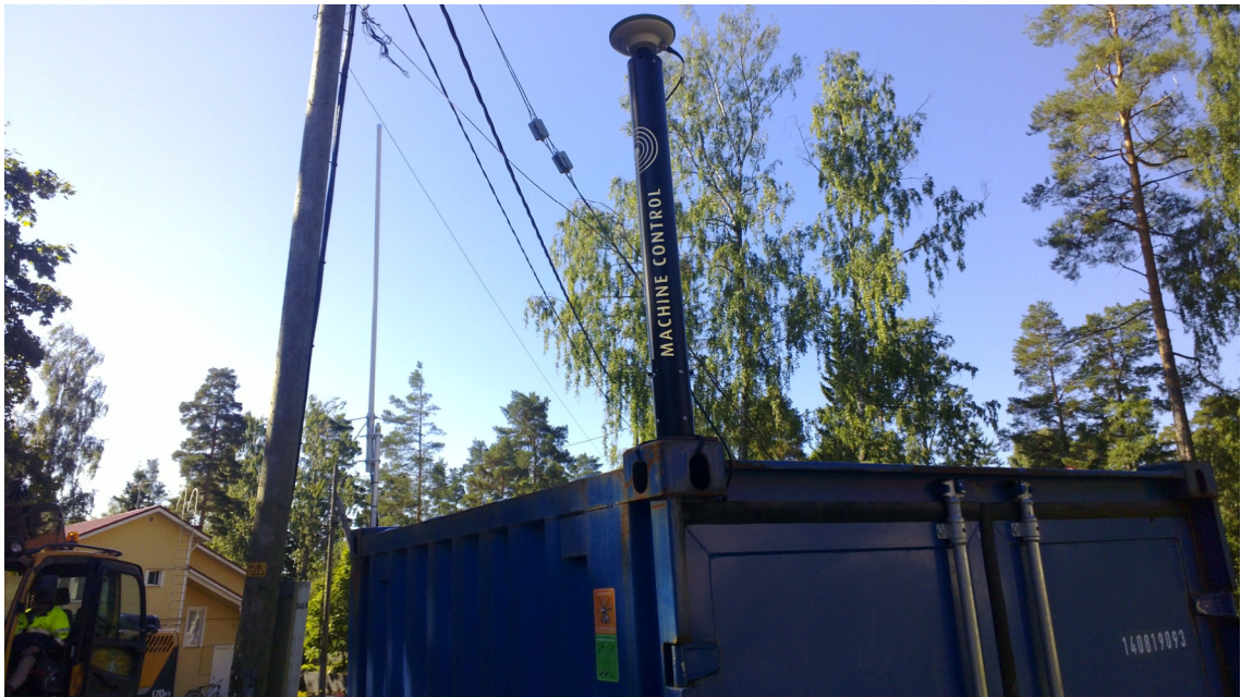
Kuva 8. Työmaatukiaseman masto ja satelliittiantenni [31]
