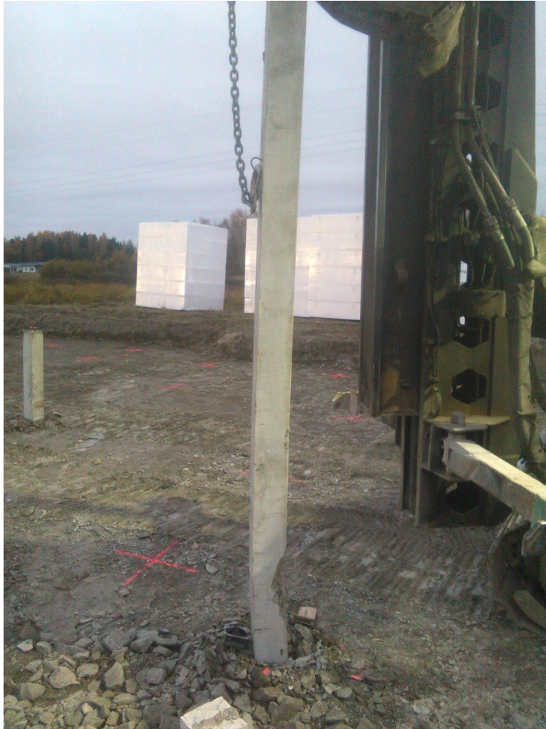
Kuva 8. Työmaalla maan alla sijaitsevaan kivenlohkareeseen hajonnut Luja-pienpaalu. (Kuva: Sami Patjas)
