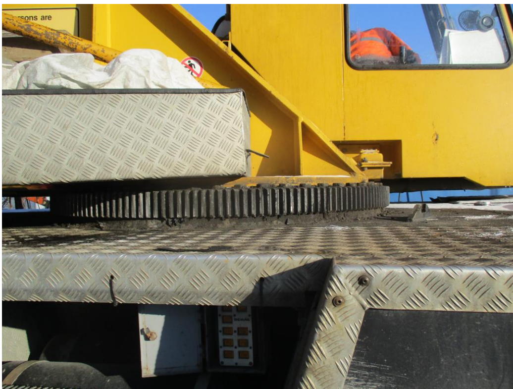
Kuva 9. Nosturin alusta tutkittiin myös repeämiltä ja vuodoilta.
