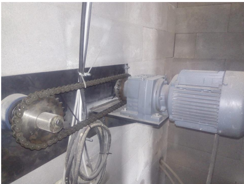
Figur 14. Bilden tagen i monteringskedet, kedjeskyddet saknas på bilden och kabelkanal.
