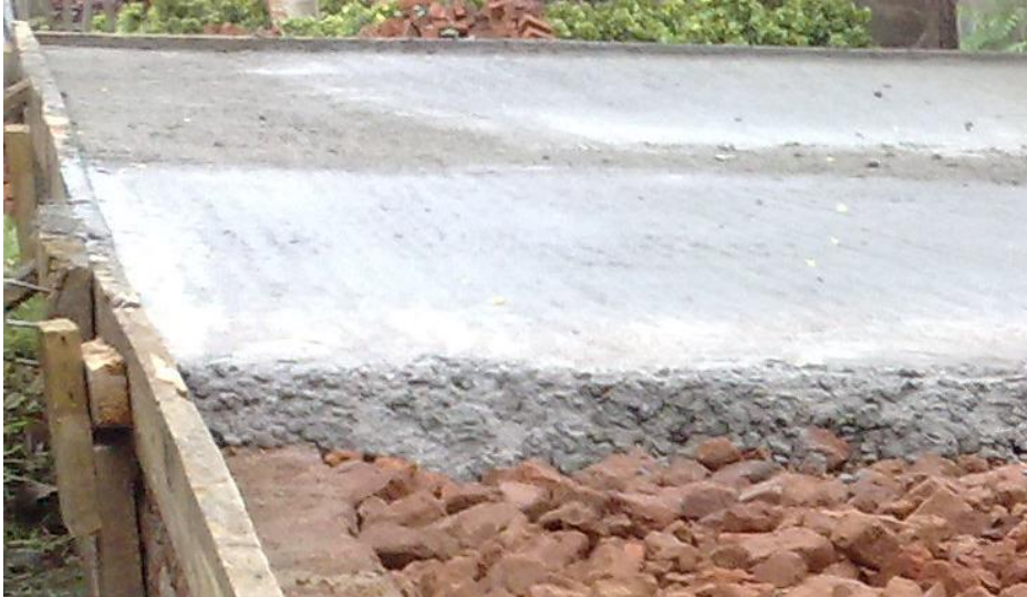
KUVA 19. Väärään korkoon rakennettu lattiavalumuotti
