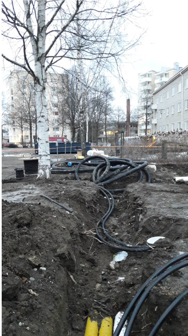
Kuva 3. Kaivuutyön yhteydessä vaurioituneita koivun juuria (Kuva: Iiris Lampi)
