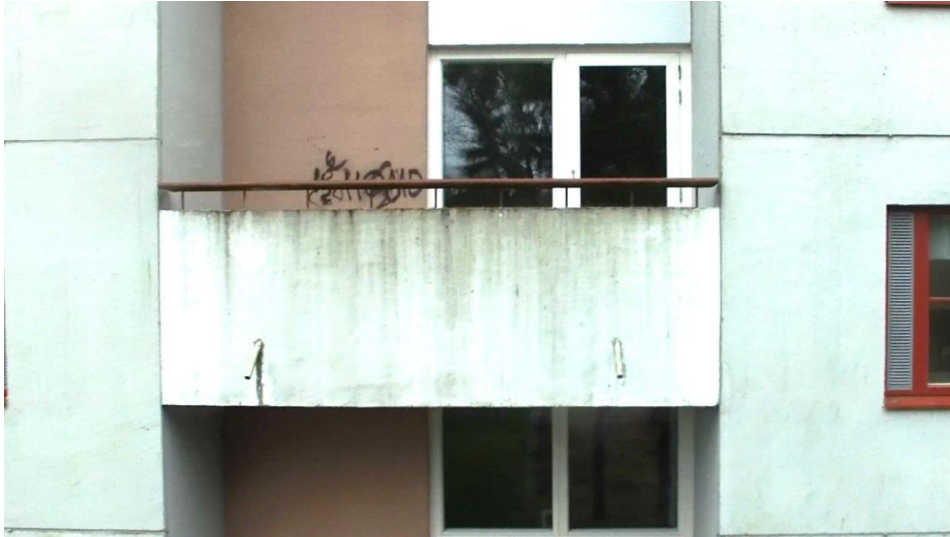
KUVA 14. Tuuletusparvekekaiteessa olevaa leväkasvustoa ja vuotava vedenpoistoputki, kuva irrotettu videokuvasta.
