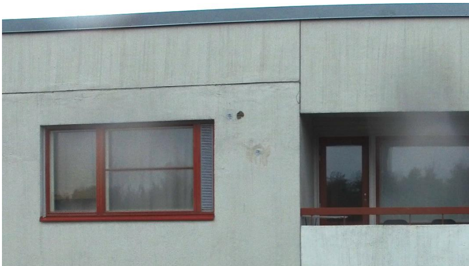
KUVA 13. Julkisivulla havaittu korroosiovaurio, kuva irrotettu videokuvasta.
