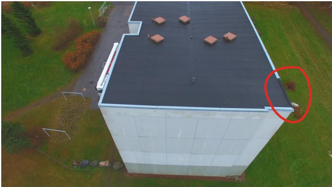
KUVA 10. Puuttuva räystäspeltti ylhäältä päin kuvattuna, kuva irrotettu videokuvasta.
