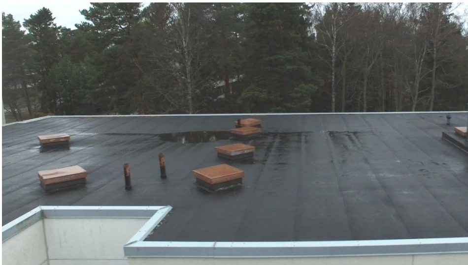
KUVA 15. Kuva toimimattomasta kattokaivosta, kuva irrotettu videokuvasta.
