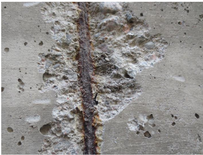
KUVA 5. Julkisivun pinnan alta esiin tullut korroosiovaurio.
