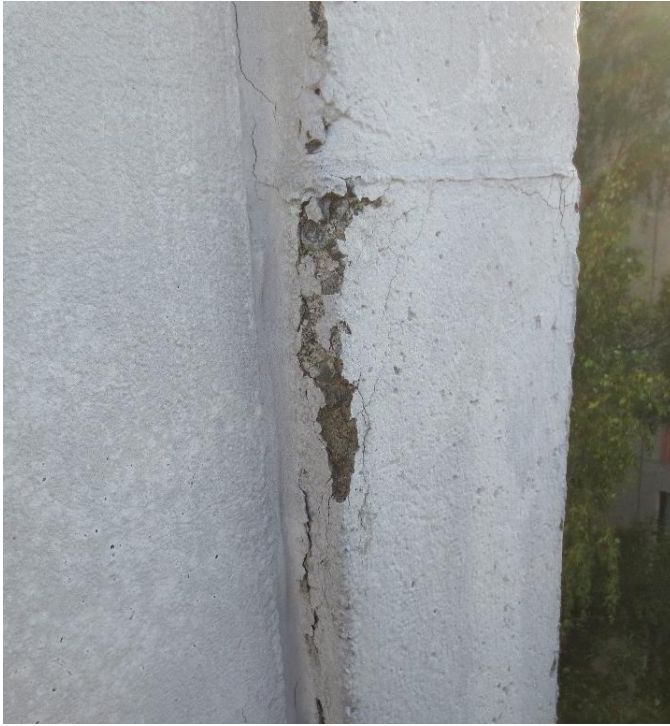
KUVA 6. Betonin pakkasrapautumisen aiheuttamaa halkeilua ja lohkeamista.
