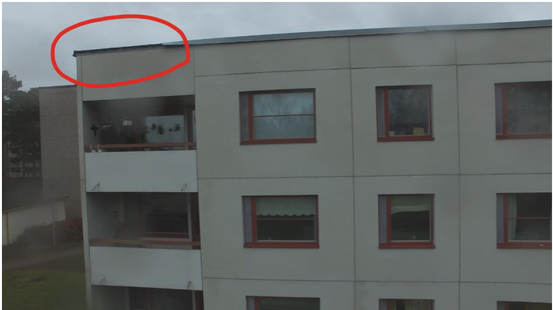
KUVA 9. Puuttuva räystäspeltti, kuva irrotettu videokuvasta.
