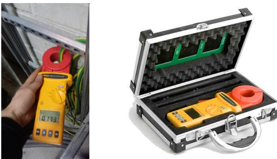
KUVA 3. Suojajohtimen jatkuvuuden mittaaminen Fluke 1630 maadoitusvastuspihtimittarilla.
