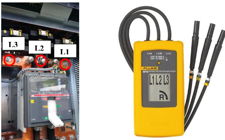
KUVA 8. Kuvasarja pyörimissuunnan mittauksesta Fluke 9040 -pyörimissuuntamittarilla.
