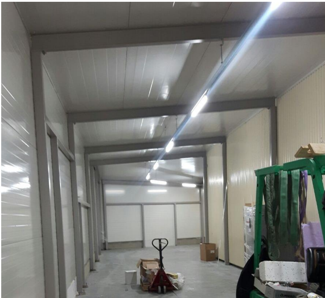
Kuva 4. Länsipuolen varaston LED-valaistusasennukset. (Ainasoja 2017.)
