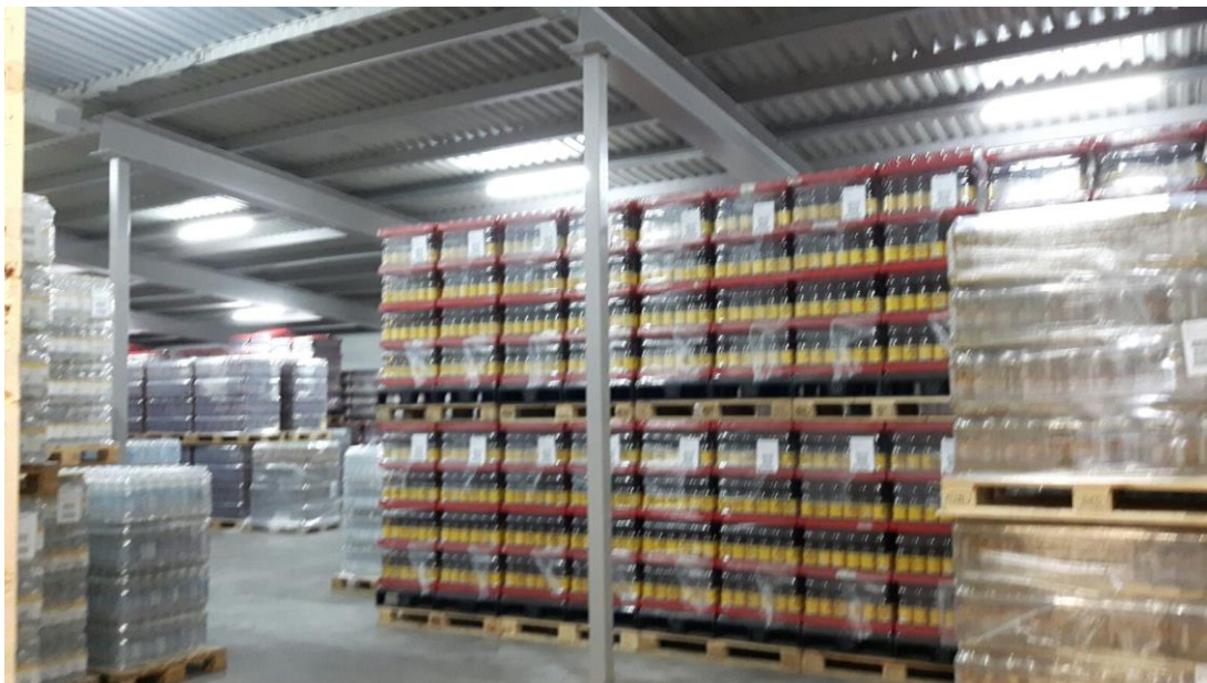
Kuva 5. Eteläpuolen varaston LED-valaistusasennukset. (Ainasoja 2017.)
