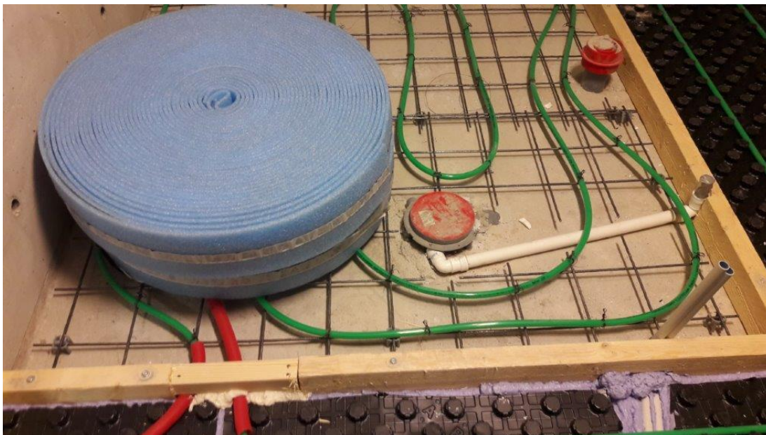
Kuva 13. Kylpyhuoneen lämmitysputket sekä reunanauha (kuvannut Juha Oksa, 2017)
