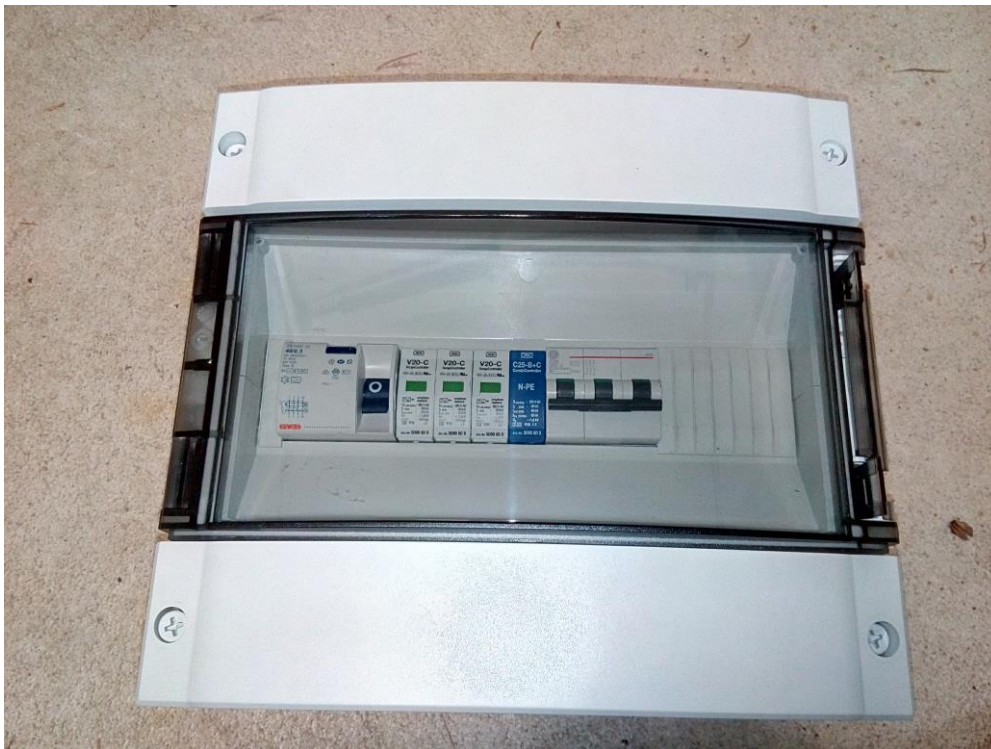
Kuva 7. AC-keskus valmiina asennettavaksi.
