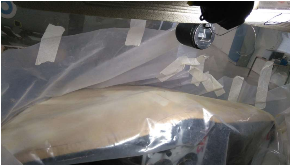
KUVA 90. Huonoksi havaittu suojausmenetelmä
