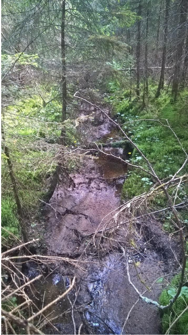
Kuvio 12. Kuva maastokäynniltä Kuorejärven valuma-alueella. Ojassa on havaittavissa merkittävää kiintoainekuormitusta. Kuva on otettu kohteelta 1, jonka karttakuva löytyy Kuorejärven vesiensuojelusuunnitelman liitteestä 1. Kuva on otettu virtaamanhallintarakenteen eteläiseltä puolelta. Kuva: Jaana Ahonen.
