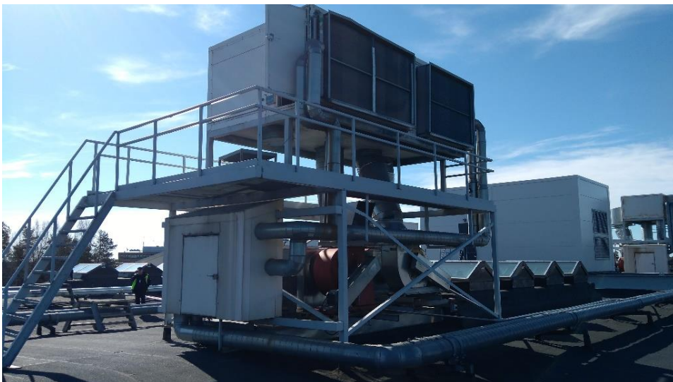
KUVA 8 Pintamaalaamon entinen suodatinkammio ja Ecoterm LTO-kennot
