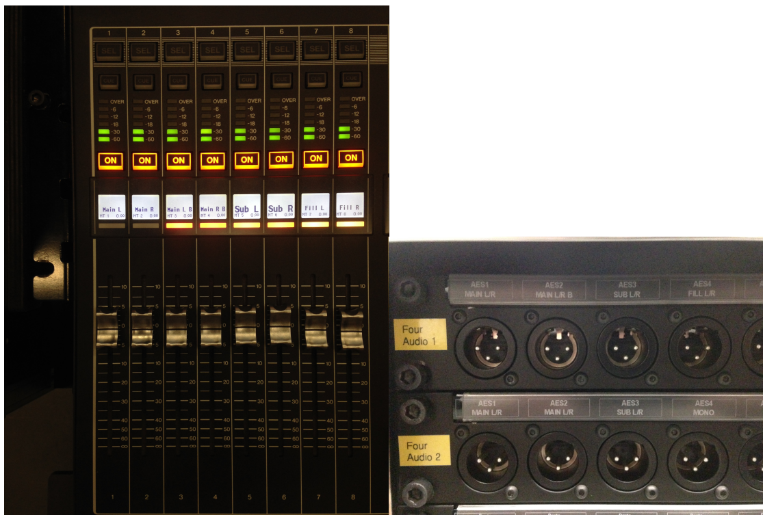
Kuva 20: Alttarin Yamaha QL1 äänipöydän matriisikanavat, joista ohjataan ääni järjestelmän eri kaiutinryhmille omat signaalinsa. Signaalit lähetetään dante-verkossa lavalla olevaan signaalinjakokeskukseen. (Samuel Merisalo)
