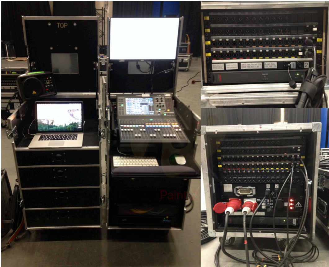
Kuva 18: Altteri ja signaalinjakokeskukset kaapeloituna. Likkojen Lenkki 2017-tapahtuman esivalmistelut käynnissä. (Samuel Merisalo)
