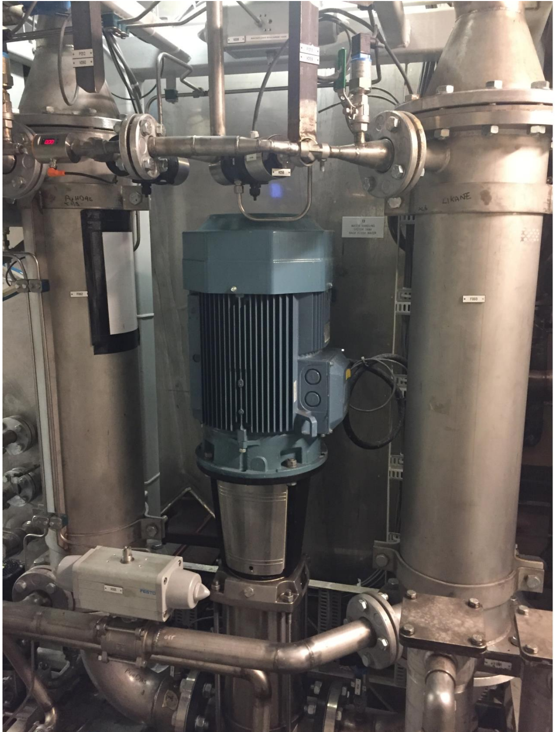
Kuva 7. MS Ailan vedenpuhdistuslaitos.
