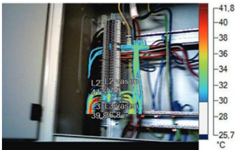
KUVA 8. Löysä liitos riviliittimessä (ST 53.62, 2014).
