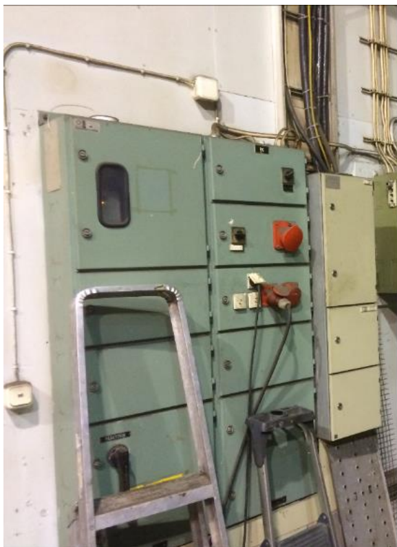
KUVA 12. Vanhemman teollisuushallin pääkeskus (Niko Putkonen, 2017.)
