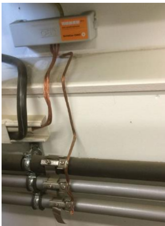
KUVA 5. Toimistohallirakennuksen maadoitetut vesijohtoputkistot (Niko Putkonen, 2017.)
