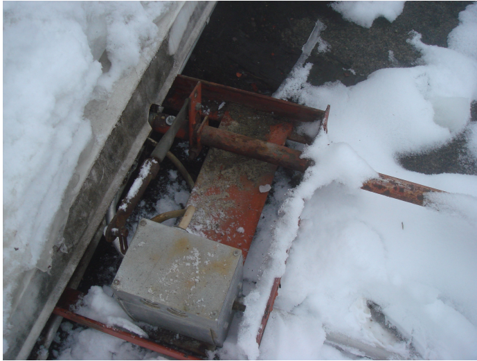
Kuva 16. Peltimoottori ja ohjaava yhdysputki.
