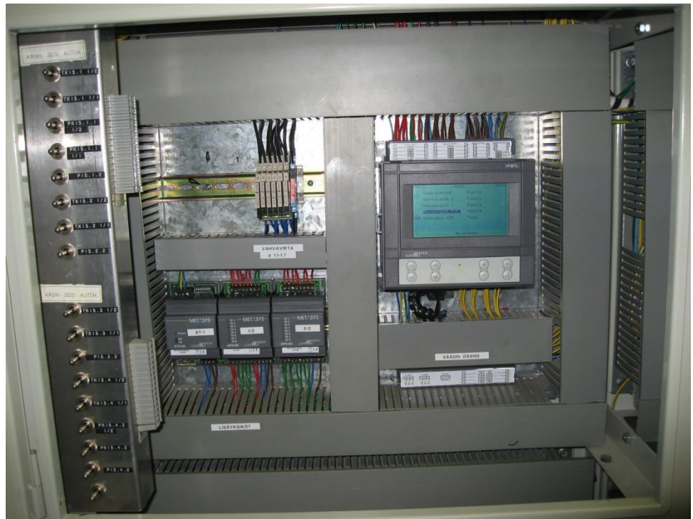
Kuva 1: Kuvassa on erääseen saneerauskohteeseen DX-järjestelmällä tehty valvomoalakeskus. Kuvassa oikealla on pääsäädin ja vasemmalla alhaalla säätimeen kytketyt lisäyksiköt.
