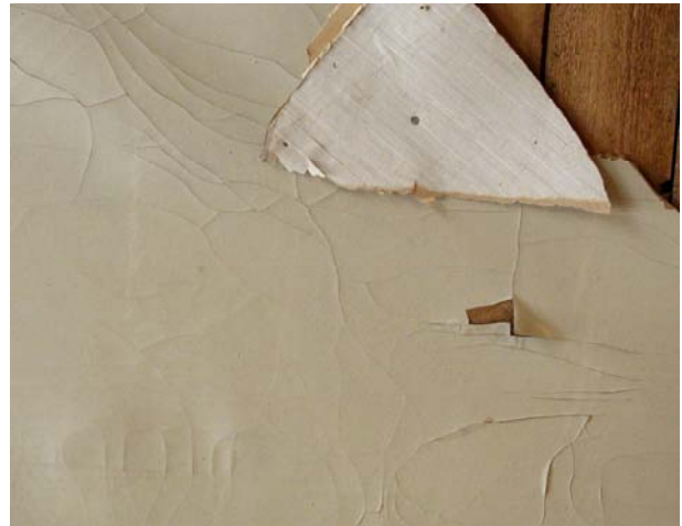
Kuva 4. Krakeloitunut maalipinta (Lehtinen 2010).
