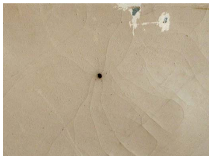
Kuva 6. Naulan aiheuttama reikä ja maalipinnan krakeloituma (Lehtinen 2010).
