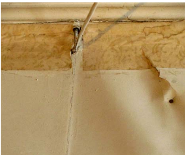
Kuva 5. Reunaosan vesivaurioitunut tapetti, sähköjohdon aiheuttamia vauriota, naulan aiheuttama maalipinnan krakeloituma (Lehtinen 2010).
