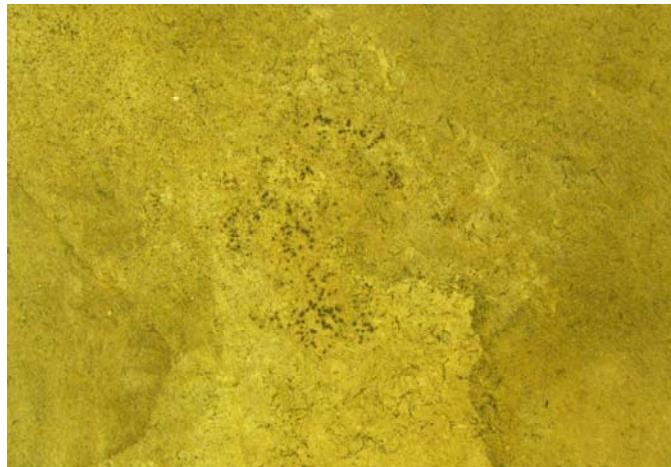
Kuva 9. Vesivaurio ja hometta irtopalan taustapuolella (Lehtinen 2010).
