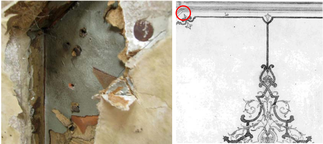
Kuvat 32 ja 33. Vasemmalla alkuperäisen koristemaalauksen fragmentti, oikealla fragmentin kohta merkittynä suunnitelmapiirustukseen (Kuva 32. Lehtinen 2010; Kuva 33. Suomen rakennustaiteen museo).
