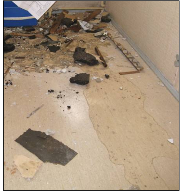
Kuva 11. Vettä vuotaa kolmanteen kerrokseen. (Lukkala 2010.)
