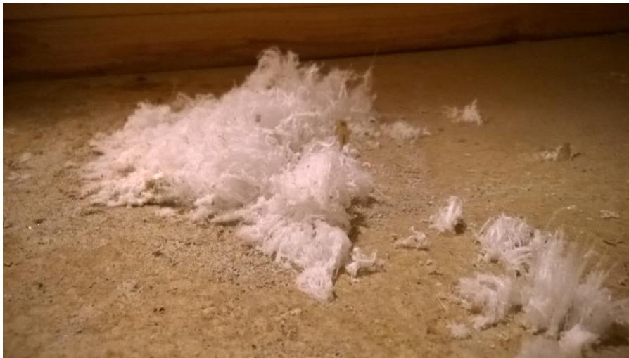
Kuva 9. Suolakertymä kellarin lattialla. Suomenlinna C 76. Kuvaaja Jenni Sundberg. 2014.
