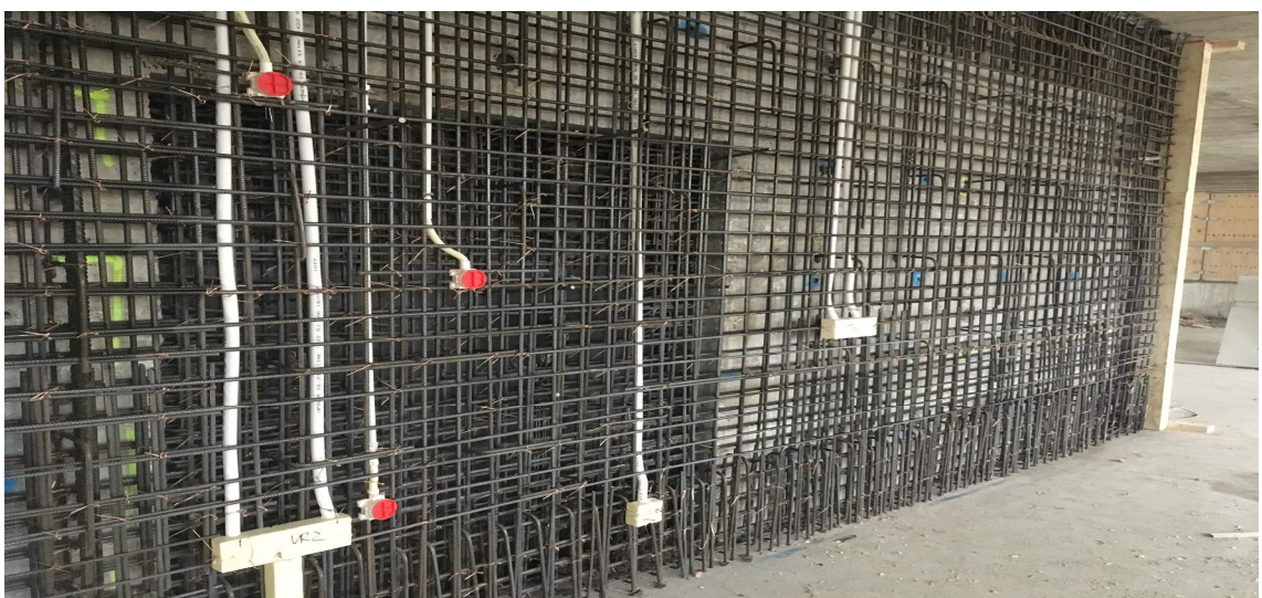
Kuva 9. Sähköputkituksia ja rasioita raudoitetussa seinässä. Lisäksi varaukset pex-putkille ja hana- ja kulmarasioille.
