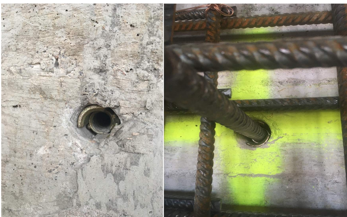
Kuva 22. Vasemmalla rakenteeseen kiristetty dywidag-ankkuri mallia 15 F 2128. Oikealla ankkuriin kiristetty dywidag-tanko.
