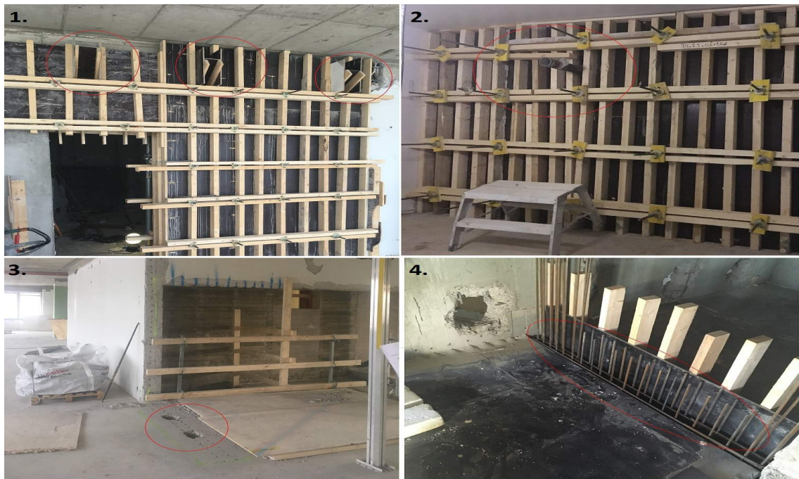
Kuva 8. 1. Valuleuka, 2. Valunatsa, 3. Holviin porattu tai piikattu reiät seinän valua varten 4. Seinä voidaan valaa ylhäältä ilman esteitä.
