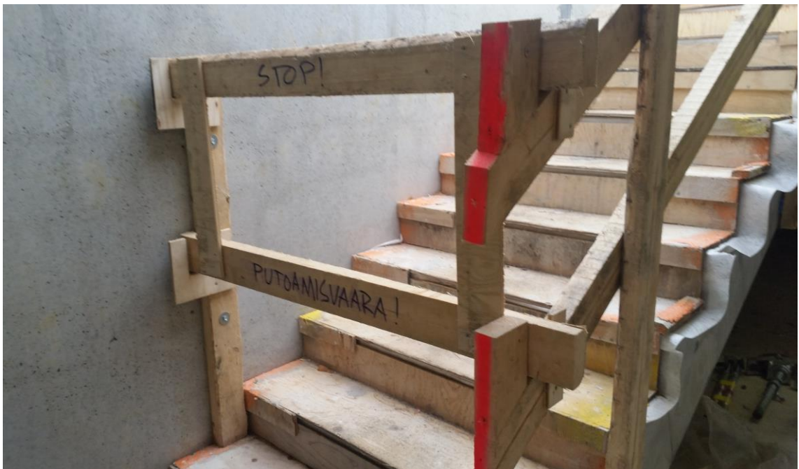
Kuva 4. Kulku holville estetty
