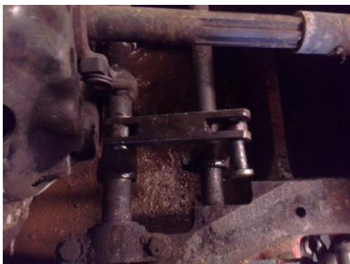
Kuva 28 Vääntynyt linja vipujen välillä
