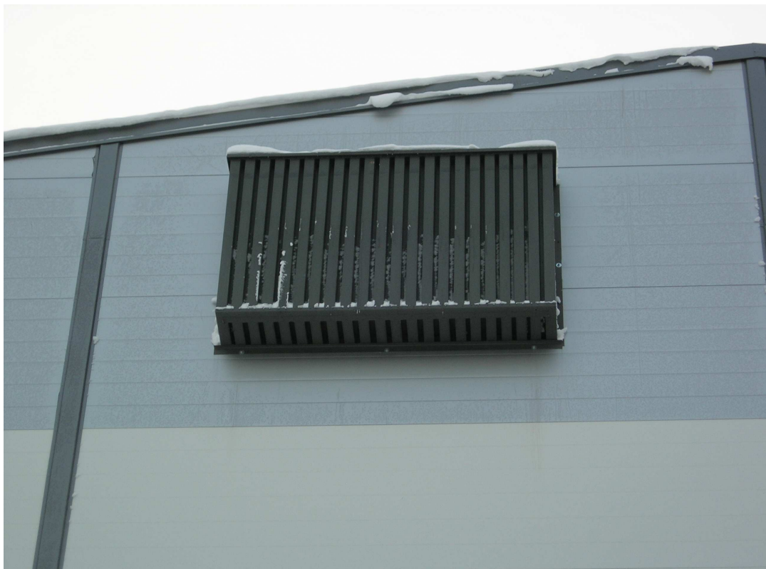
Kuva 4. Hallin pohjoispään ulkoilmasäleikkönä toimiva lumisieppari
