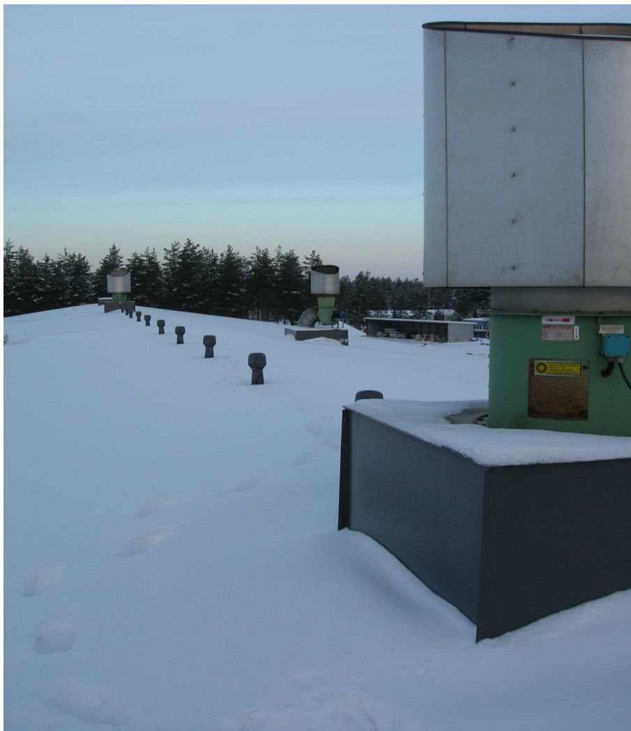
Kuva 5. Aksiaalipuhaltimet sekä keskellä kohdepoistojärjestelmän keskipakopuhallin
