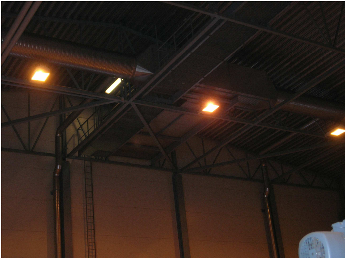
Kuva 2. Hallin pohjoispään tuloilmakone
