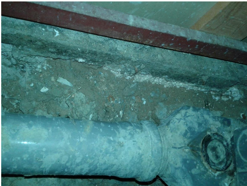
KUVA 34. Huoltoluukusta suora yhteys maaperään (Sainio 2017-06-14)
