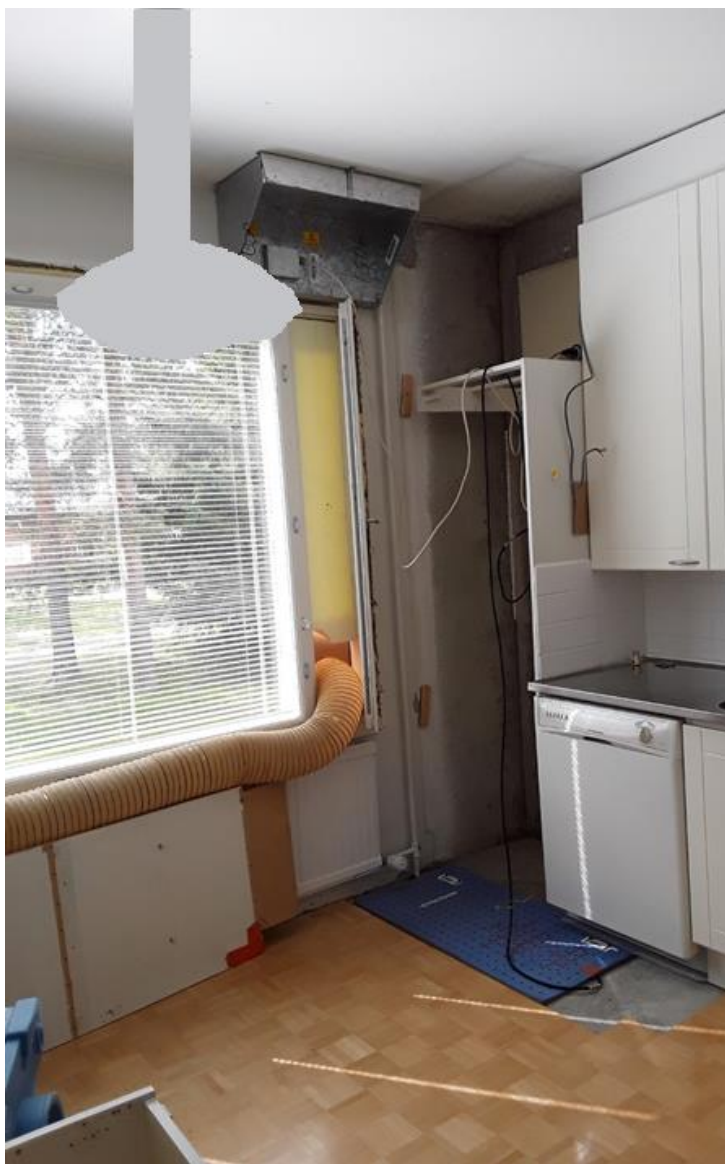
KUVA 13. Pikakuivaus. matalalämpöpaneeli katossa, matalalämpömatto lattialla (Sainio 2017-08-14)
