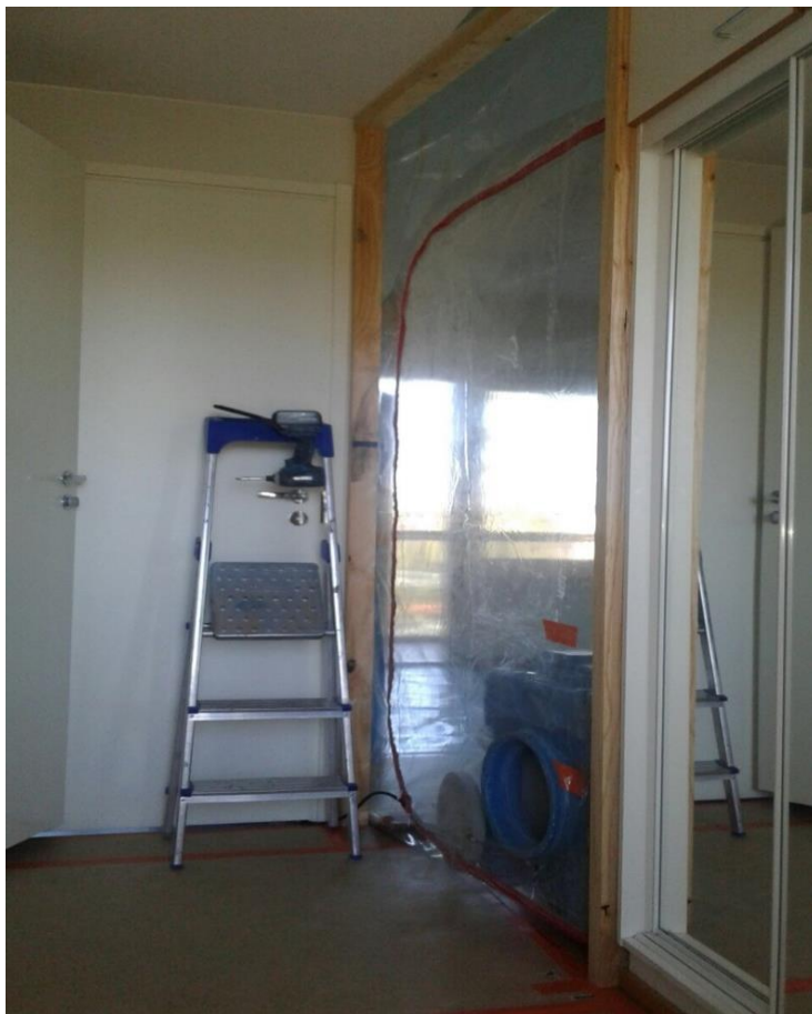
Kuva 4. Hepa-suodattimella varustettu alipaineistaja (Sainio 8.6.2017)
