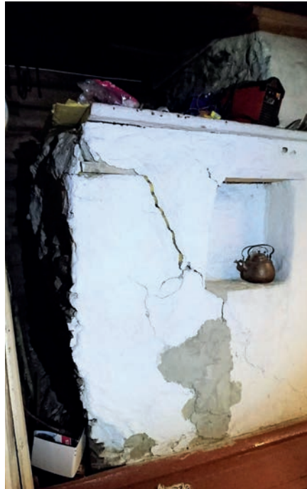
Tulisijassa rakenteellinen puute
