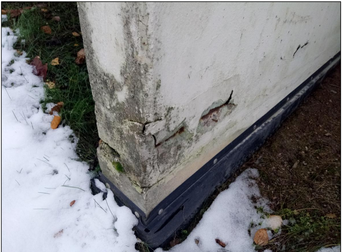
KUVA 16: Rapautunut pieliseinän pinta
