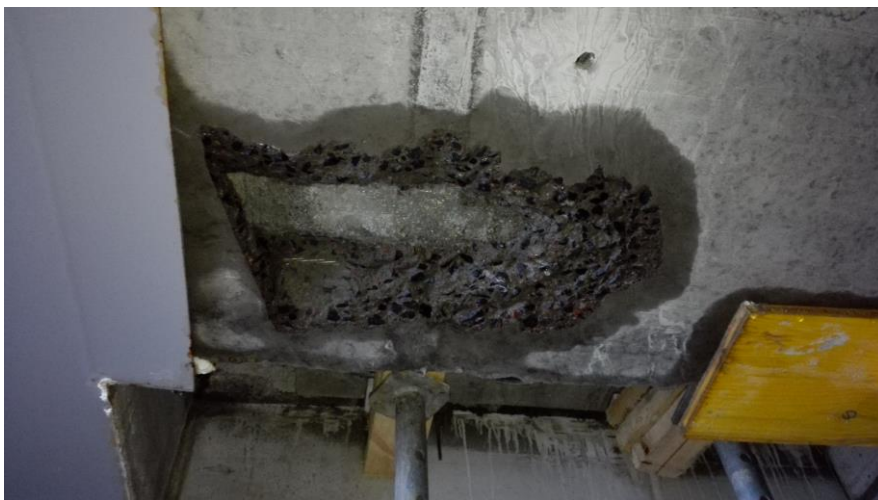
KUVA 1. Jään rikkoma ontelolaatta alhaalta kuvattuna.
