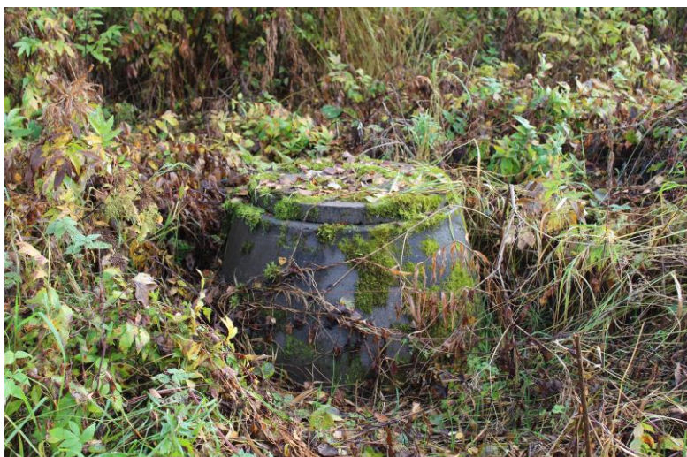
Figur 5. Exempel på en "hemlagad" brunn som borde bytas ut.
