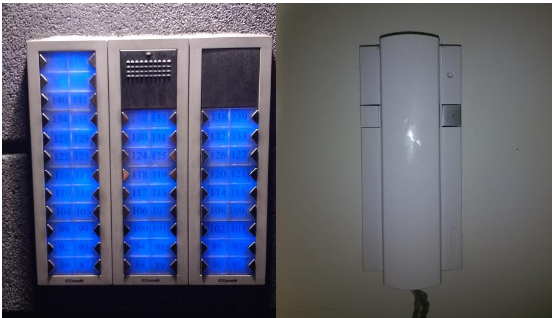
Kuva 11 Ovipuhelinjärjestelmän nimitaulu (vasemmalla), ja siihen liittyvä huoneistopuhelin, jossa ovenavauspainike.
