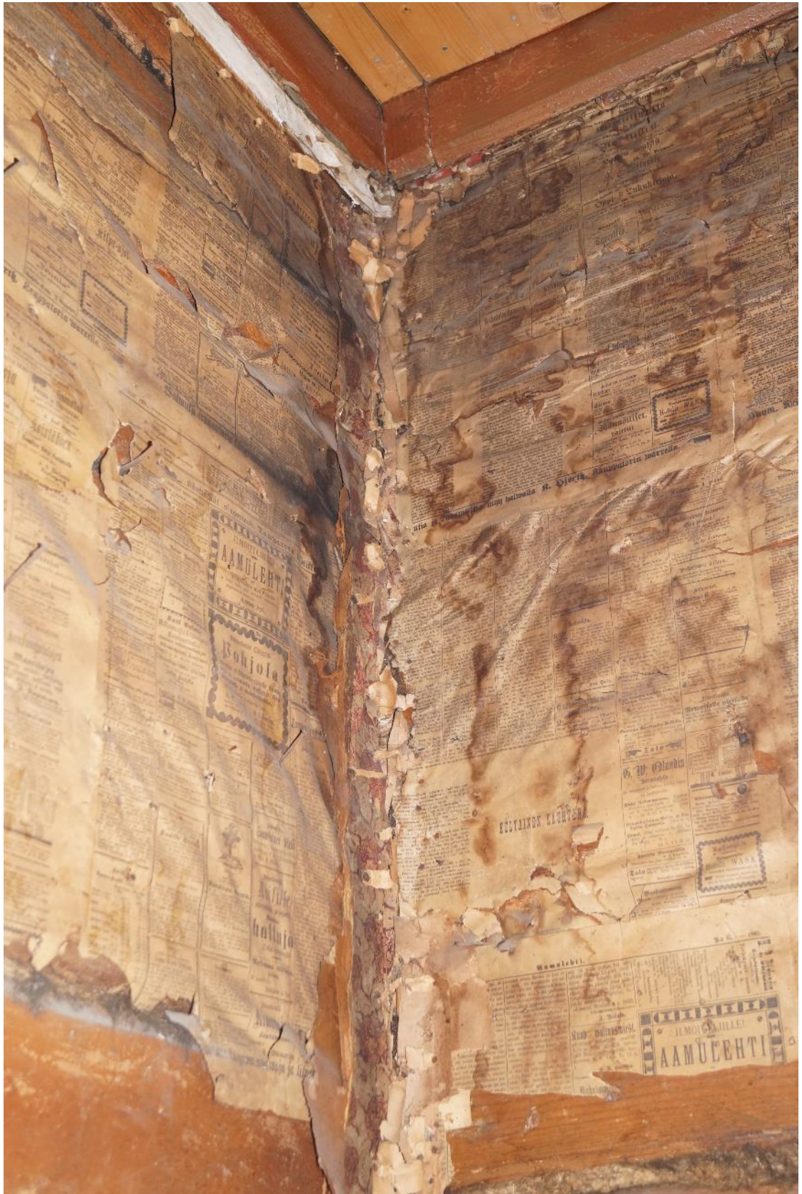
Nurkkaus, jossa kosteusvaurio (Vattulainen 2017)
