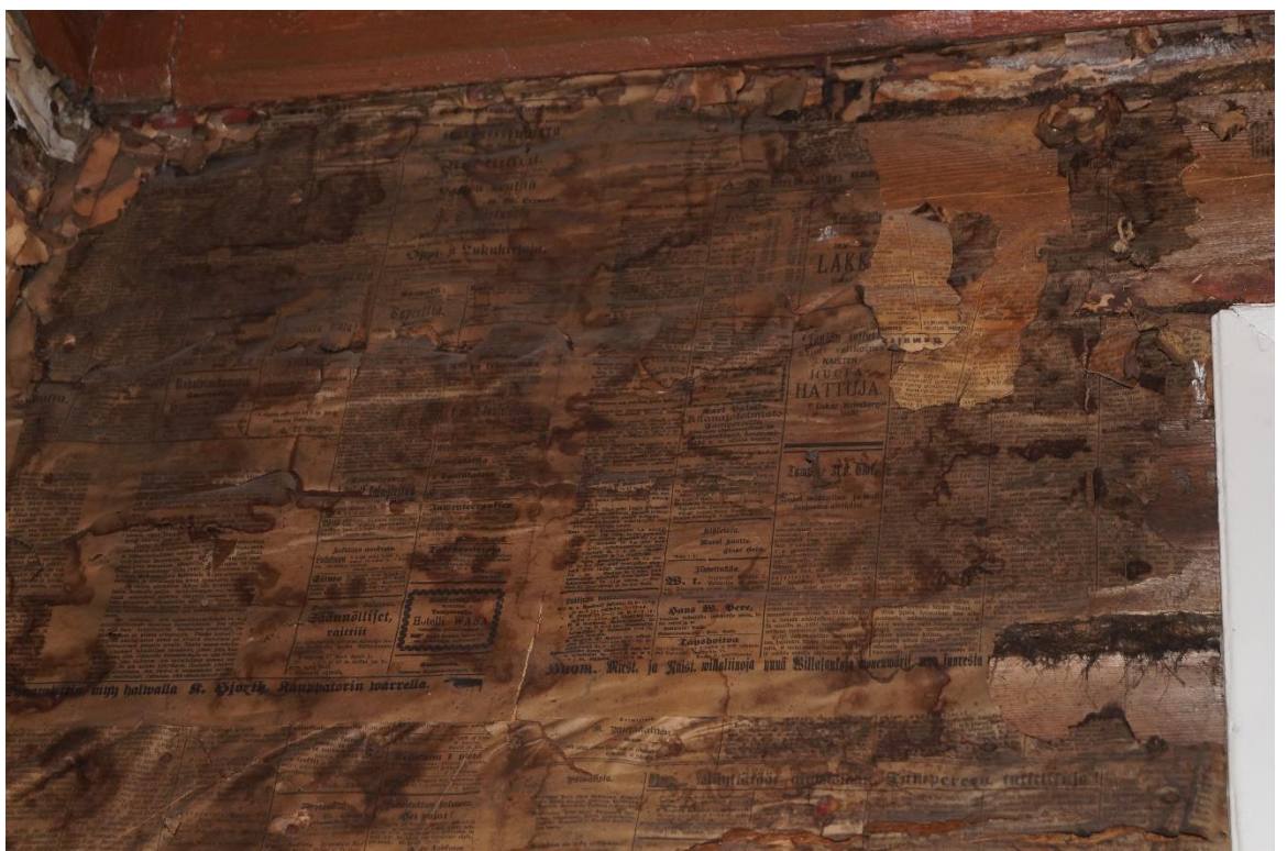
Kosteusvaurio ja tummunut sanomalehti, pohjoisseinä (Vattulainen 2017)
