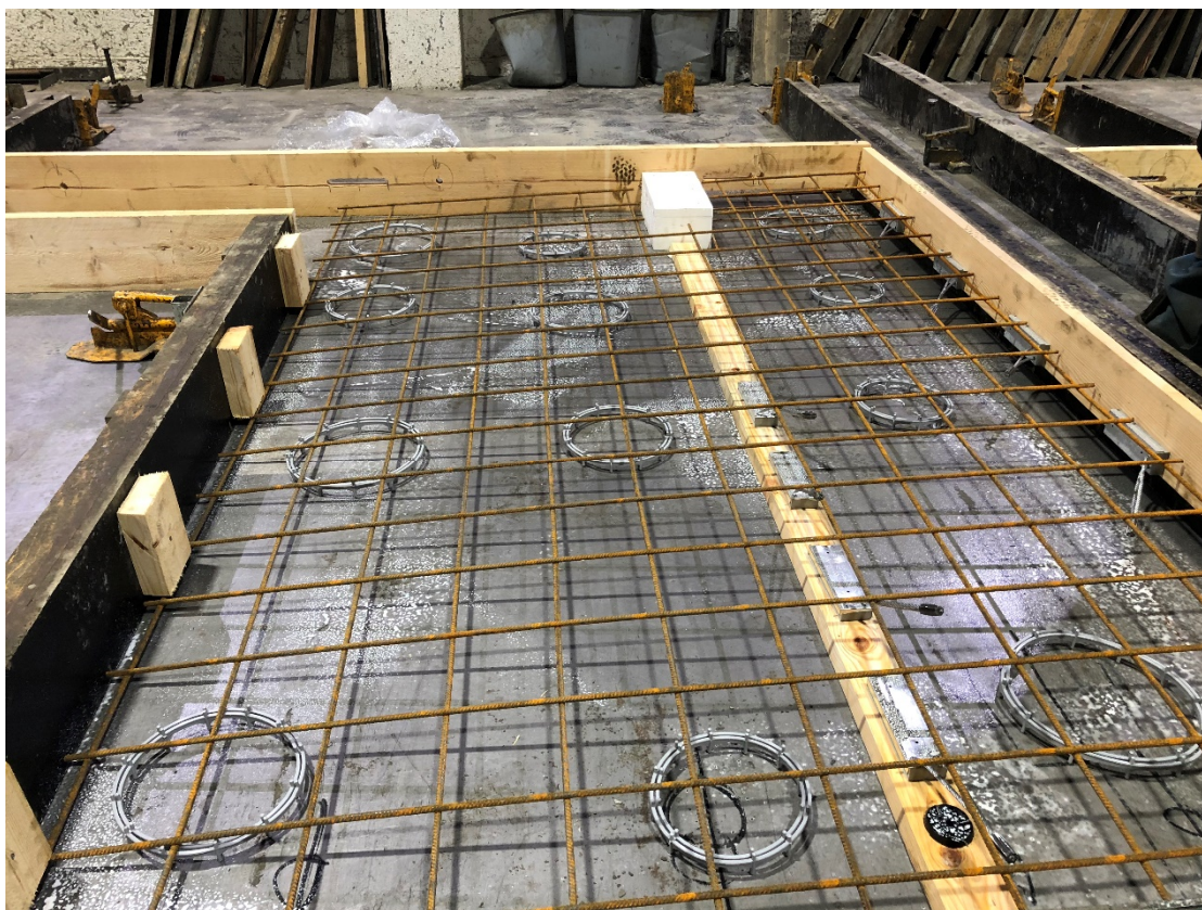
Kuva 29. Valokuva mittatarkasta verkosta, joka ei mahdu reunavaarnan alle sen ollessa asennettuna muottiin ennen verkkoa. (Leinonen 2017)
