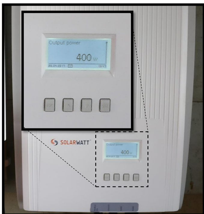
KUVA 3. Invertteri seinälle asennettuna. Näytössä näkyy hetkellinen sähkön tuotanto.
